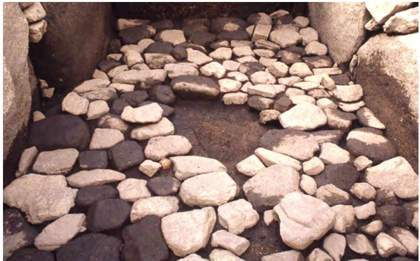
写真5 石敷欠落部の様子
