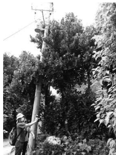
写真12 電柱に覆いかぶさるフクギ
