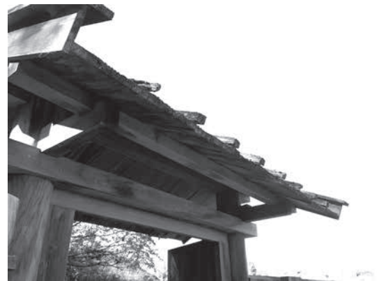
写真4 老朽化の進む正門の屋根
